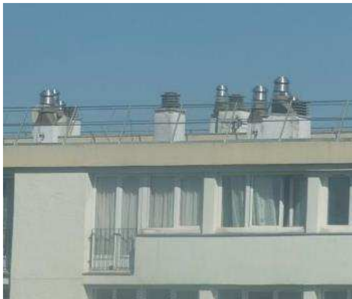
Tourelles d'extraction , cliché pris dans les Yvelines
